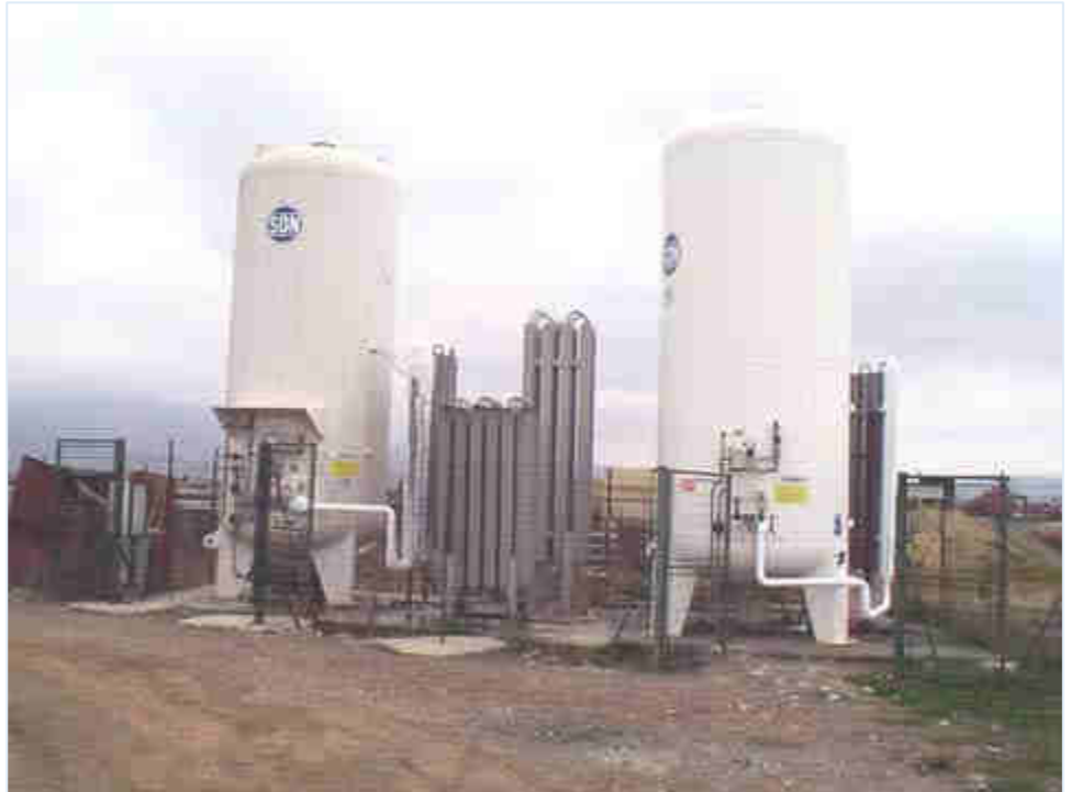
Serbatoi di ossigeno liquido
